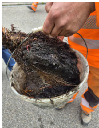
Wurzel trifft Kanal – keine gute Zusammenarbeit
